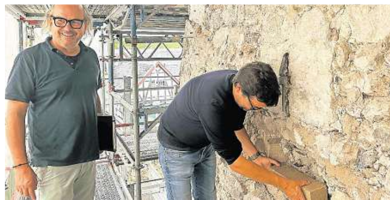
Architekt Max Ernst (l.) und Steinmetz Jan Schwierien prüfen, ob die neuen Tuffsteine in die ausgebrochenen Stellen im Mauerwerk des Kirchturms passen.
